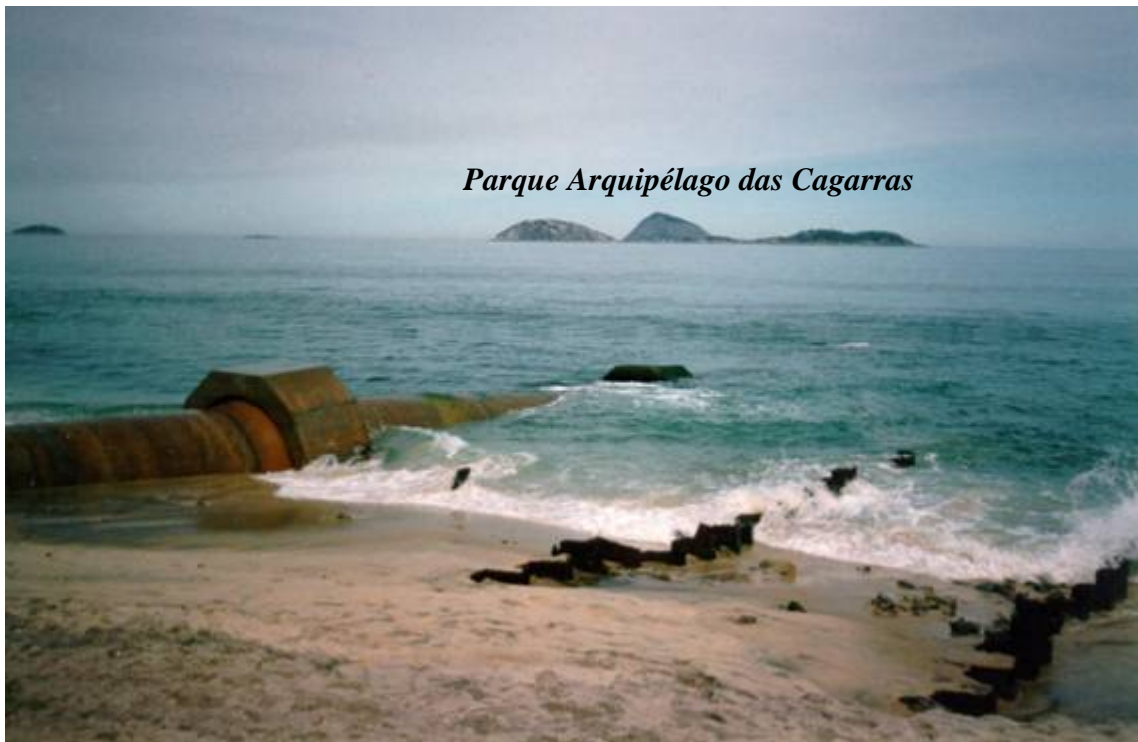
Fig. 9. Intensa erosão relacionada à ENSO expôs estruturas e, ressaca de sudeste produz o rompimento do emissário.
