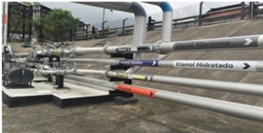
Figura 1: Dutos de Recebimento de Produto
