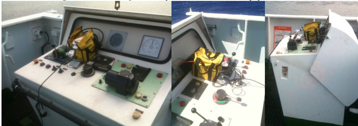
Figuras 4, 5 e 6: Painéis externos de comando sobre os quais foram instalados os receptores GPS
