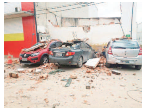
PAREDE DESABOU e atingiu três veículos em Seropédica
