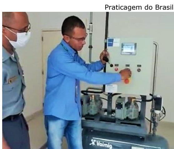
Sistema de vácuo para o Hospital Naval do Recife.
