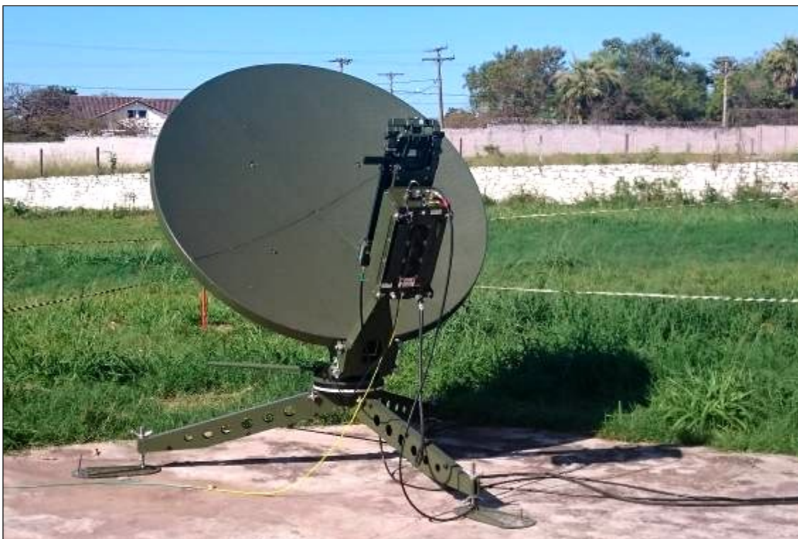
Terminal Terrestre empregado pela Marinha para comunicação por satélite na Operação Ágata9
