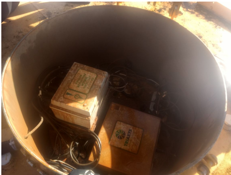
Figura 11: Foto do payload da boia CABO FRIO, com destaque para o alagamento da parte interna da boia.
